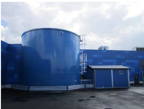
Exempel på en sprinklertank
