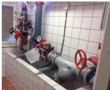
Exempel på en sprinklerbassäng
