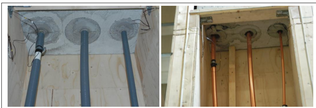
Oisolerade PEX-rör med skyddsrör och oisolerade kopparrör
