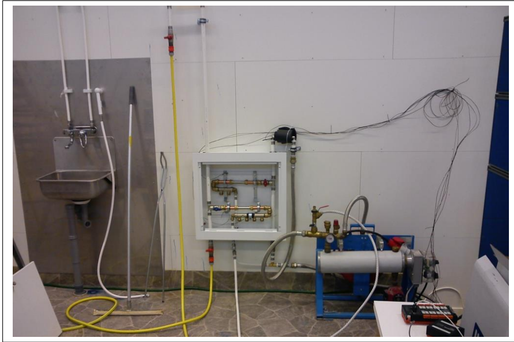
Fördelarskåp med monterade fördelarrör. Mobil elpanna med cirkulationspump
